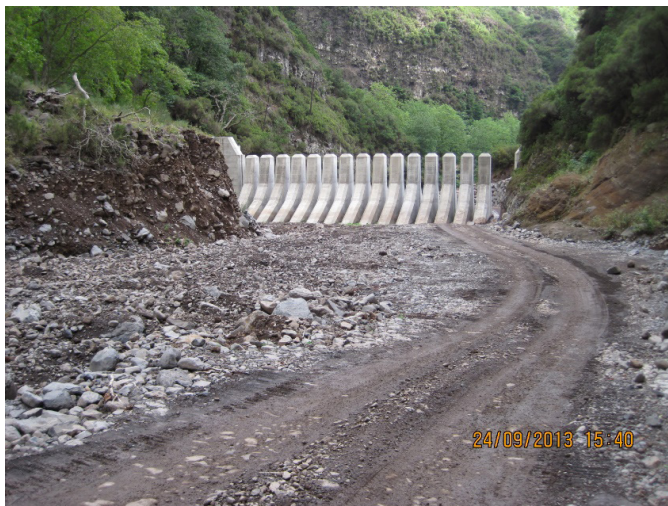
Figura 1 - Exemplo de uma das barreiras fendidas construídas na ribeira de Santa Luzia, identificada no quadro i com a sigla SL1.
