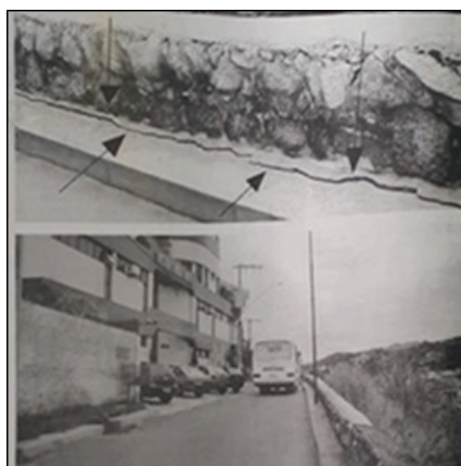
Fot. 9 - Rachaduras na calçada e muretas (Fonte: Gazeta de São João del-Rei, 2003b, p. 2).
