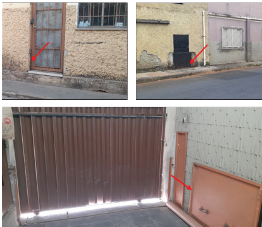
Fot. 46 - Comportas protetoras de inundação/alagamento (Fotografia de Ferreira et al. , 2023c)
