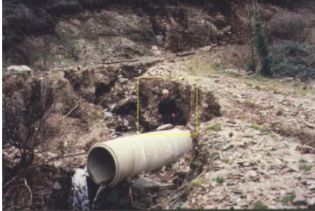
Fotografia 11. Pormenor da estrada que, por obstrução do aqueduto a montante, se transformou em linha de água.
