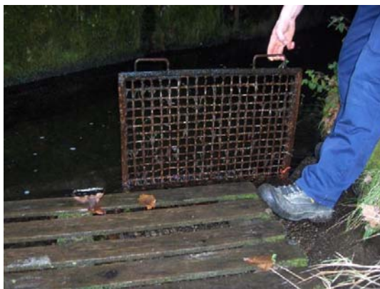
Fotografia 3. Pormenor de uma grelha de retenção de materiais da barragem da Senhora do Desterro.
