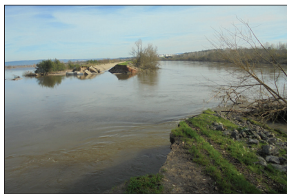
Fot. 10 - Cheia de 21 de dezembro de 2019: rutura do dique longitudinal direito do leito central do Mondego em Santo Varão (Fotografia de João Pardal, 24 de dezembro de 2019).
