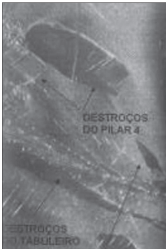
Fot. 7 - Posição final do pilar P4, tombado para montante da secção da ponte.
