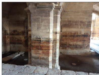
Fot. 4 - Marcas de inundação nos pilares e paredes da Igreja do Mosteiro de Santa Clara-a-Velha (Fotografia de João Pardal, 17 de julho de 2021).
