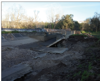
Fot. 11 - Cheia de 21 de dezembro de 2019: rutura do Canal Condutor Geral em Coimbra (Fotografia de João Pardal, 24 de dezembro de 2019).
