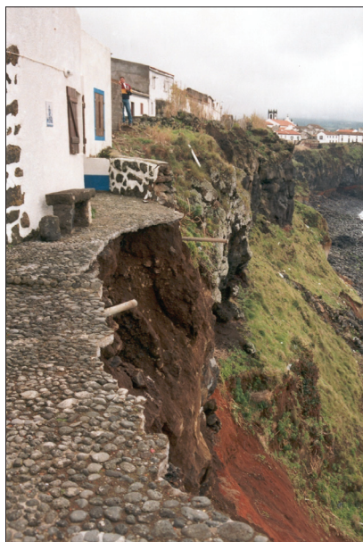
Fot 7 - Colapso quase total de um logradouro devido à erosão costeira, nas Calhetas (S. Miguel) (Fotografia de LREC-Açores, tirada em 2000).
