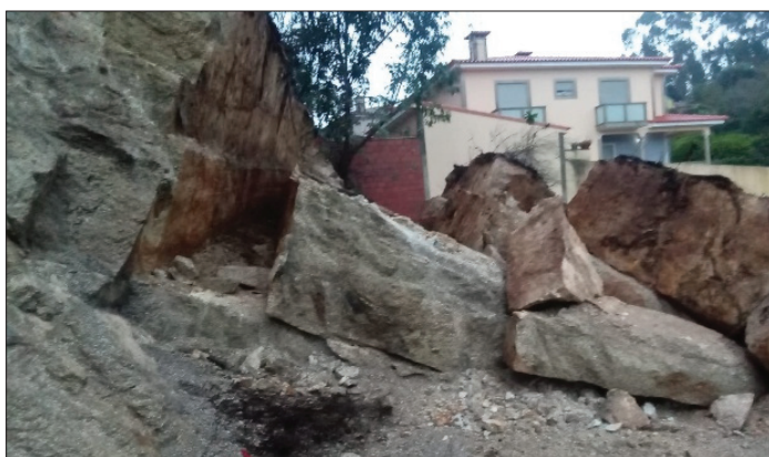
Fot. 5 - Situação do talude no lote adjacente à casa afetada, evidenciando a fraturação do granito na sequência dos trabalhos de preparação para construção (Fotografia da Câmara Municipal de Esposende).
