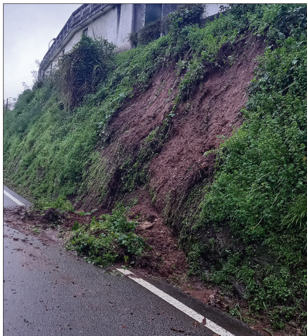
Fot. 5 - Deslizamento de terras, estrada entre Sernada e Carvoeiro, Águeda (Fotografia de Mário Talaia, tirada a 20/12/2022).
