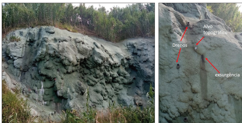
Fig. 6 - Talude monitorizado da SR4 onde se verificam escorrências de água por fissuras no betão projetado.
