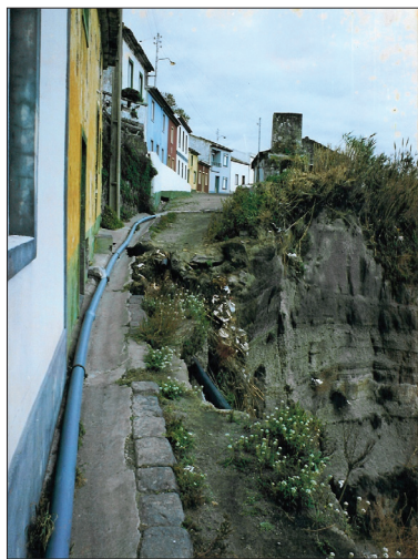
Fot. 8 - Várias casas e uma rua foram destruídas pela erosão costeira na Rocha dos Campos (Vila Franca do Campo, S. Miguel) (Fotografia de LREC-Açores, tirada em abril de 1992).
