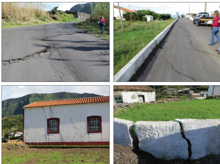
Fot 1 - Exemplos de fendas em estradas, casas e muros, resultantes da deformação do terreno (Fotografias de LREC - Açores, tirada a 13/11/2013).
