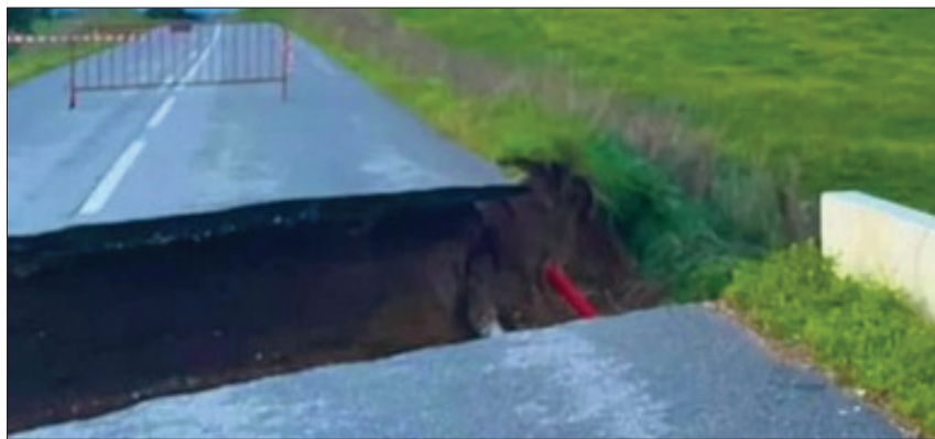
Fot. 3 - Trânsito interrompido entre Monforte e Veiros.
