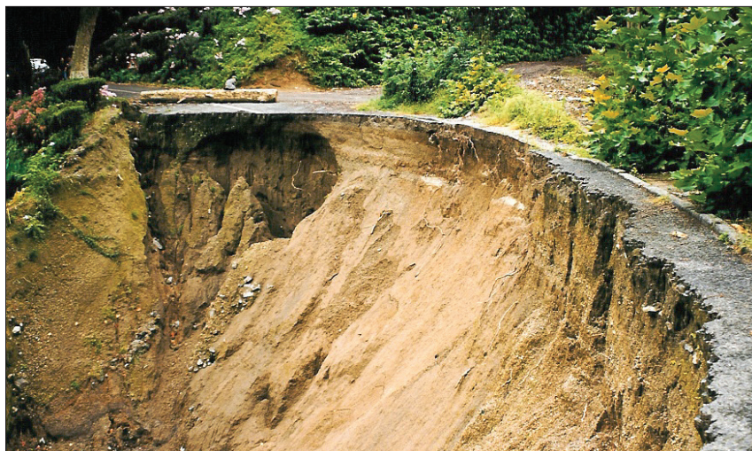
Fot. 4 - A estrada entre Furnas e Povoação foi interrompida devido a um deslizamento. (Fotografia de LREC-Açores, tirada a 31-10-1997).
