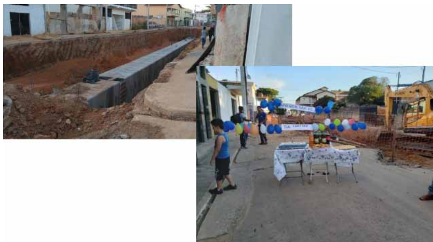
Fot. 10 – Avenida João Paulinelli de Carvalho, colapso e manutenção (Grupo do Facebook “Biografias Bambuienses”).
